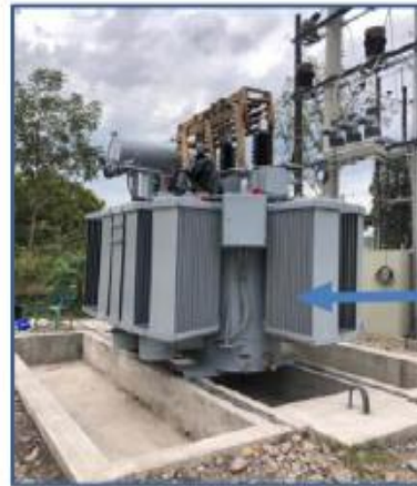
Transformador de 10 MVA Nº SERIE: 142859-1309 en sitio
